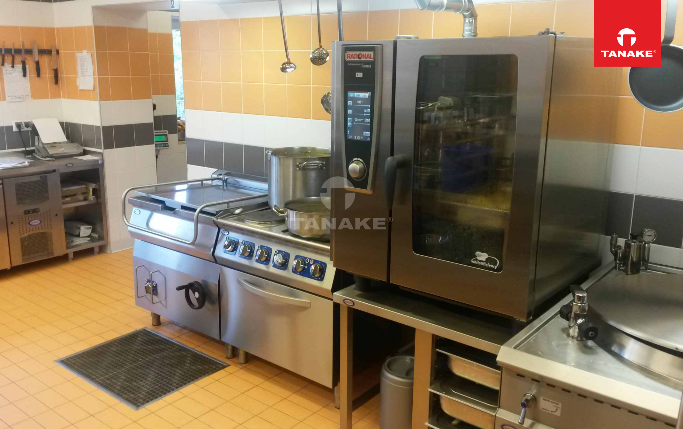
Ciąg urządzeń grzewczych pod ścianą. Na pierwszym planie piec konwekcyjno-parowy.
