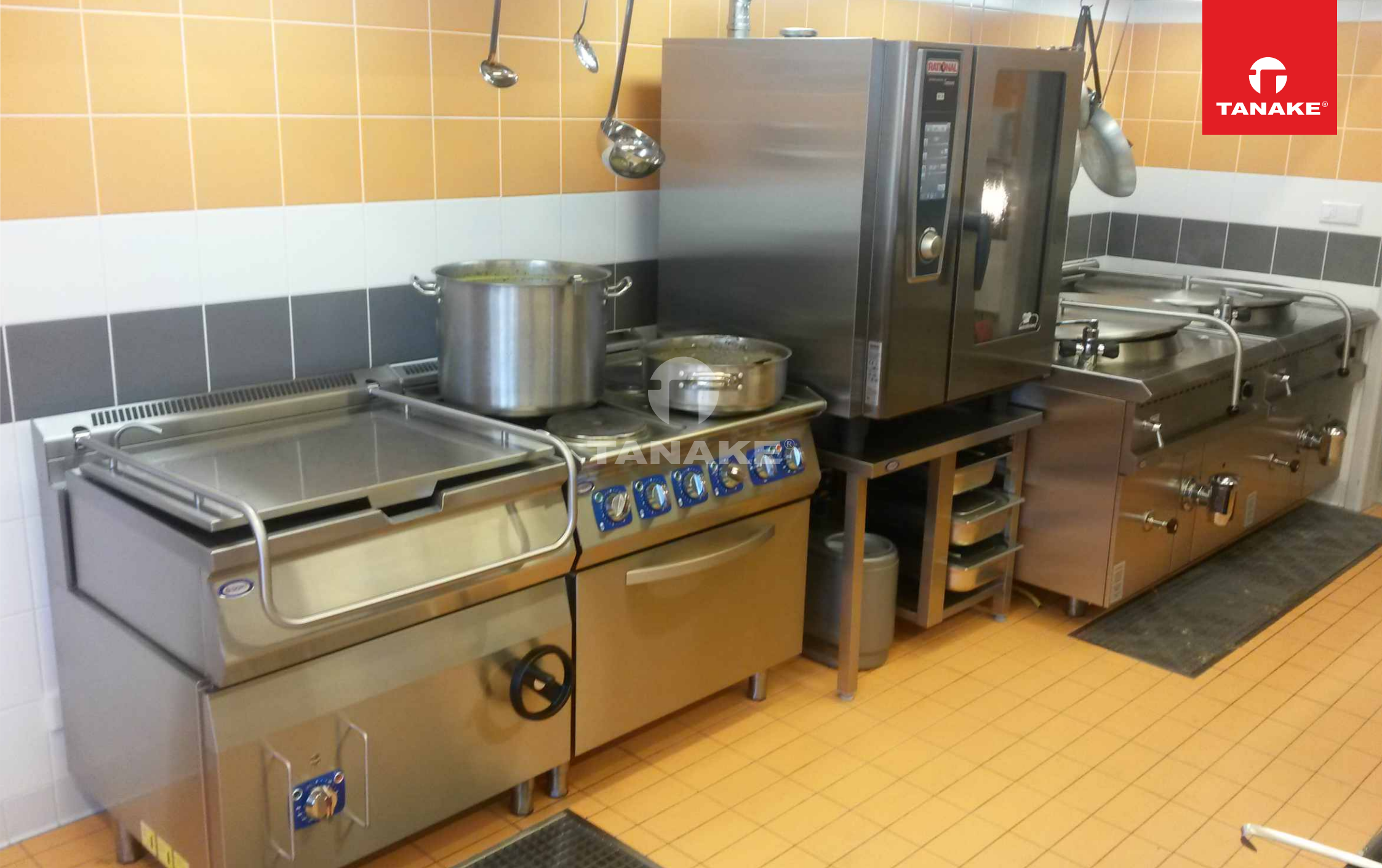
Ciąg urządzeń grzewczych pod ścianą. Na pierwszym planie patelnia wychylna i kuchnia.
